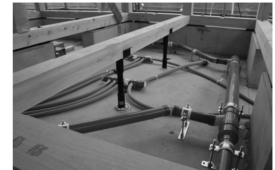
維持管理・メンテナンスのため、給水・給湯はシステム配管
